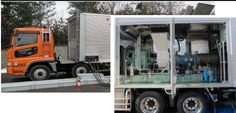
ガスタービン発電機車 (高台配備)
