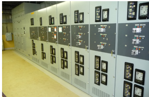
1号機 電源盤(P/C 1G-1)据付後
