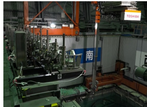
オペレーティングフロアの様子
