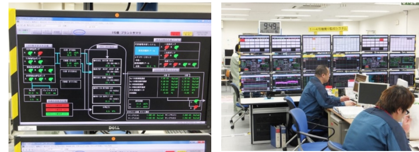
圧力容器温度や格納容器温度をはじめとした、プラントパラメーターは24時間、常に監視を継続
