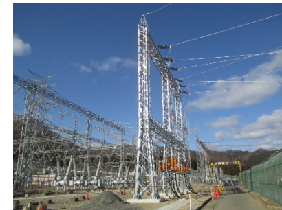
新福島変電所
