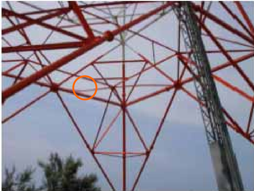
3 . 大湊側避雷鉄塔の斜材が座屈
