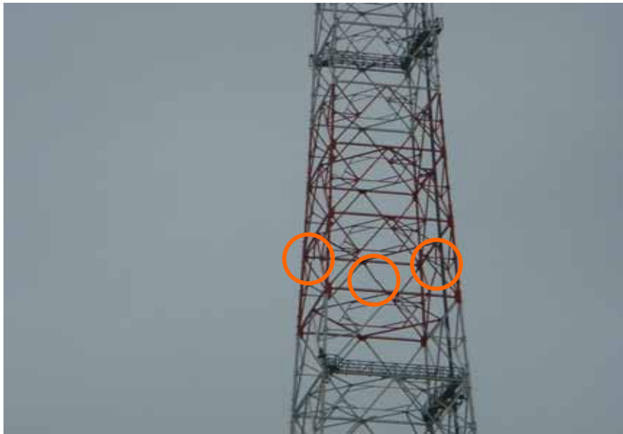
1 . 荒浜側避雷鉄塔の斜材が破損
