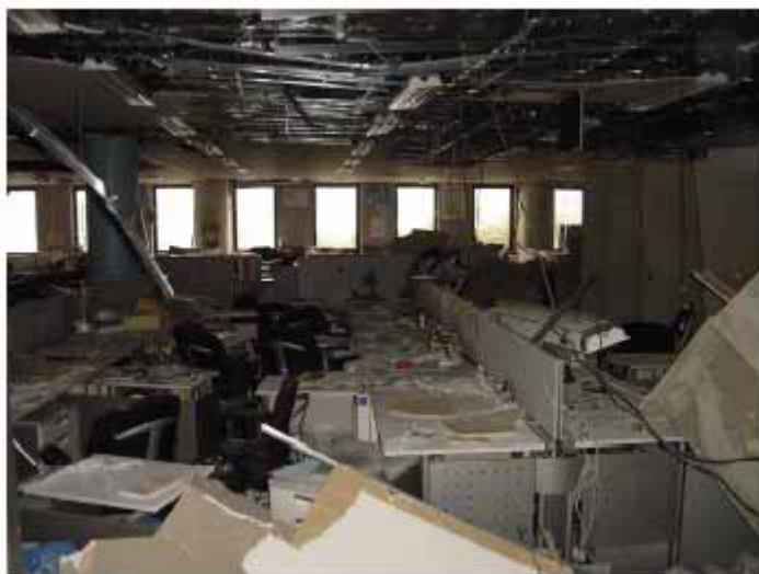
9 . 事務本館天井落下状況
