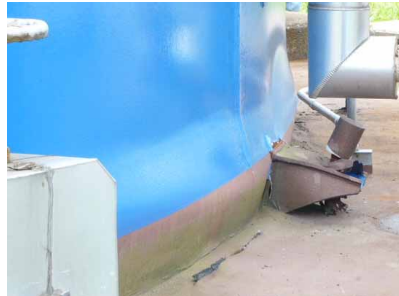
6 . 大湊側ろ過水タンクの座屈
