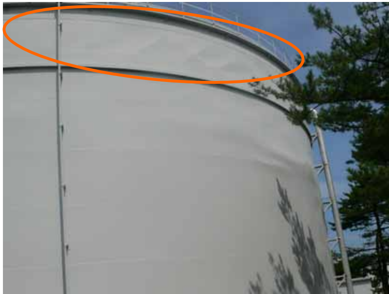
5 . 荒浜側ろ過水タンクの座屈
