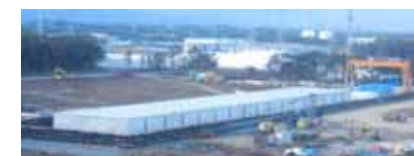
セシウム吸着塔一時保管施設（外観）
