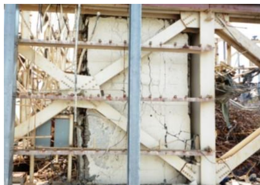
西面の壁状況
