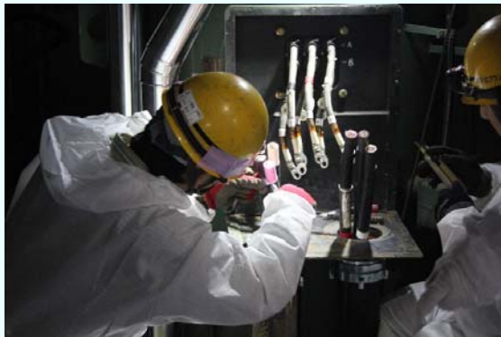
残留熱除去機器冷却海水系ポンプ(D系)電動機 本設ケーブル芯出し作業の様子 (平成25年1月22日撮影)
