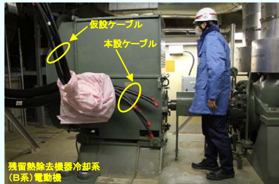
残留熱除去機器冷却系ポンプ(B系)電動機 本設ケーブル切替作業前 (平成25年1月9日撮影)
