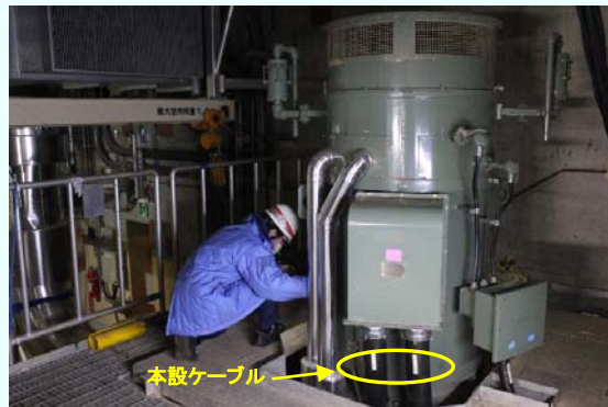
残留熱除去機器冷却海水系ポンプ(D系)電動機 確認運転の様子 【平成25年1月30日本設化完了】 (平成25年1月30日撮影)
