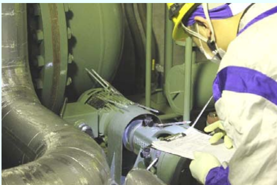
電動機(清水加熱器ポンプ※1)確認運転の様子 （平成25年1月24日撮影）
