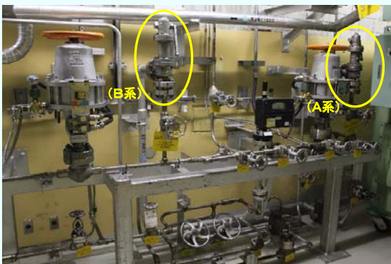
原子炉冷却材浄化系のパージライン（全体） 本設配管（弁）での接続状況 【平成25年1月22日本設化完了】 （平成25年1月24日撮影）
