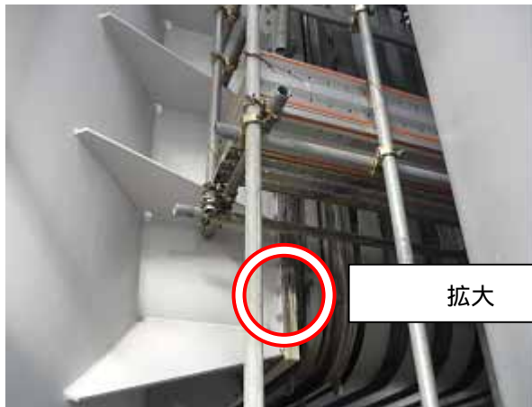
1号機主排気筒と主排気ダクトのつなぎ目部における 空気の漏えい箇所（平成21年9月10日確認・補修済み）
