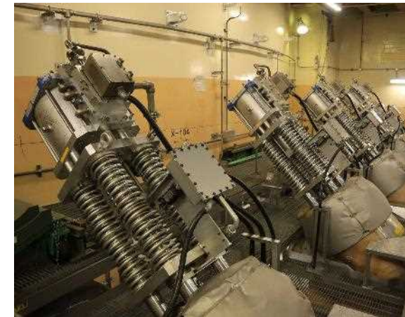
確認する弁の例 主蒸気隔離弁
