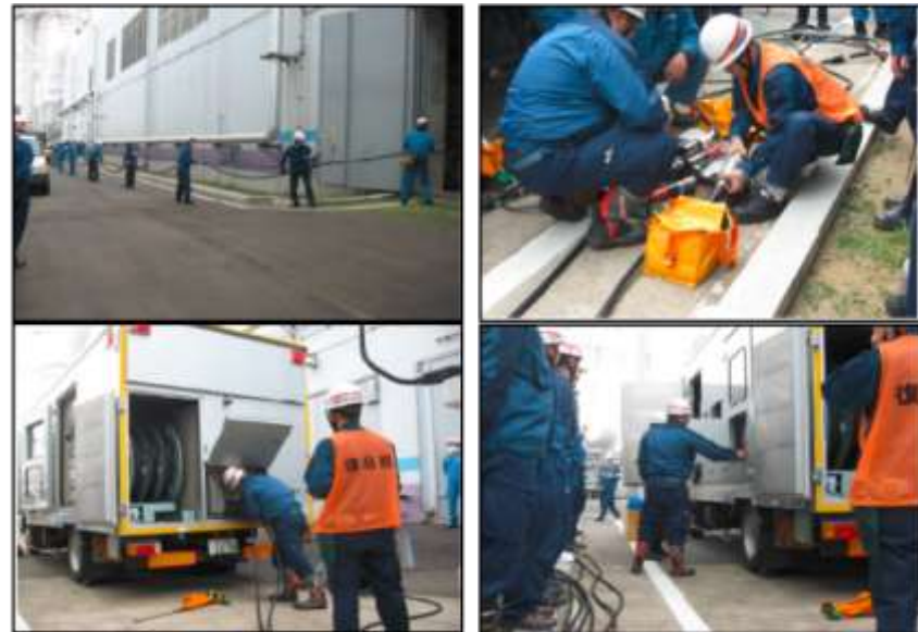
ガスタービン発電機起動訓練の様子
