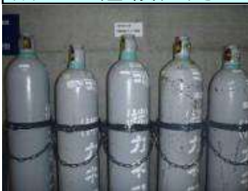
予備ポンベの配備
