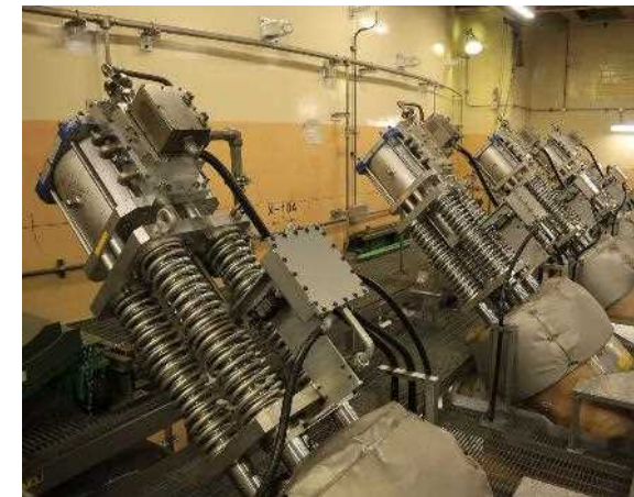
確認する弁の例 主蒸気隔離弁
