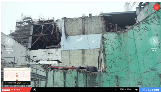
TEPCO 水素爆発した3号機原子炉建屋
