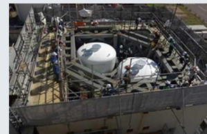
7号機 地上式フィルタベント設備 (よう素フィルタ設置状況)
