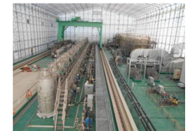
(高性能多核種除去設備)
