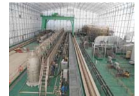
(高性能多核種除去設備の設置状況)
