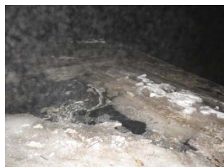
写真-3: シャーベット状の雪の滞留(導水路内)
