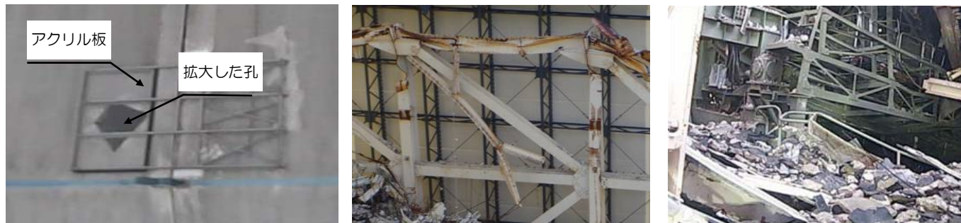
図9：1号機原子炉建屋上部 屋根パネル孔塞ぎ状況およびガレキ調査状況
