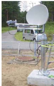
衛星通信設備
