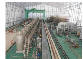
(高性能多核種除去設備の設置状況)
