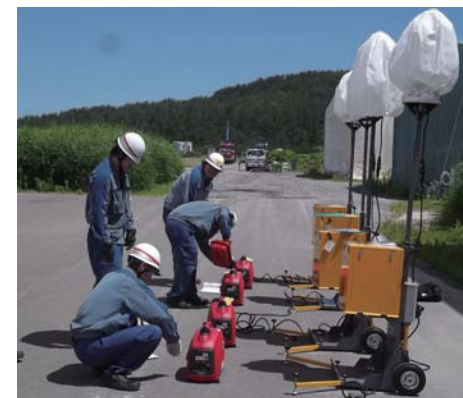
緊急用照明装置の点検
