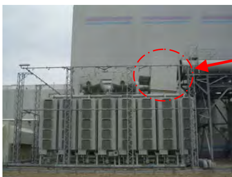
3号機主変圧器
