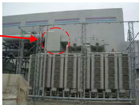
1号機主変圧器
