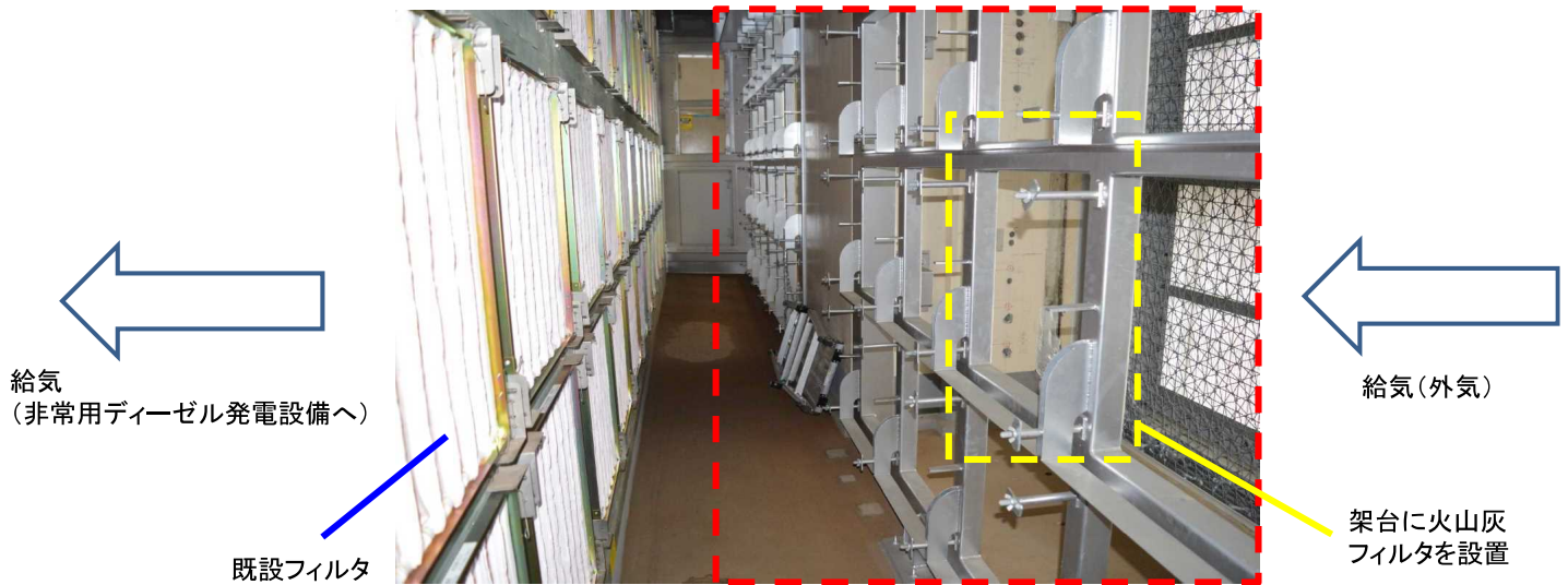
火山灰フィルタ設置架台
