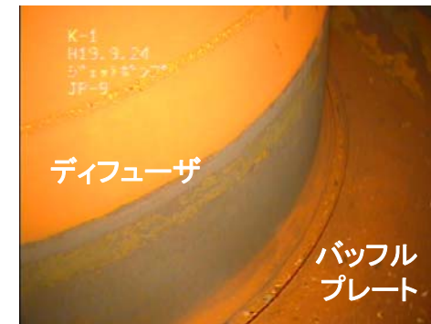
ジェットポンプ下部
