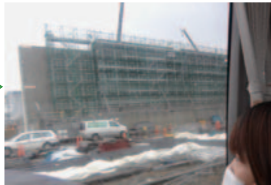
バスに乗って発電所構内見学
