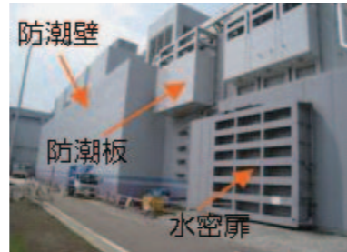
防潮壁・防潮板
