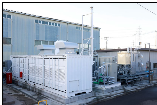
【500kWワンパックP2Gシステム全景】
