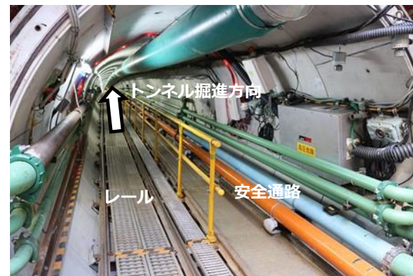
トンネル内部安全設備の整備状況
