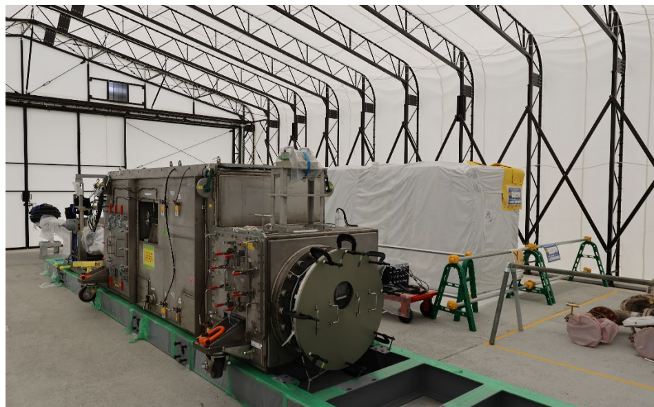
テレスコ式装置の全景（接続管側）
