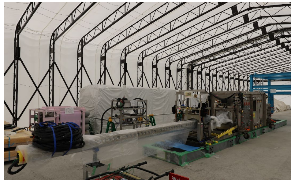
テレスコ式装置の全景（ガイドパイプ側）
