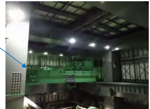
天井クレーン
