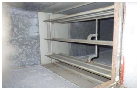
ダクトダンパ 閉止前
