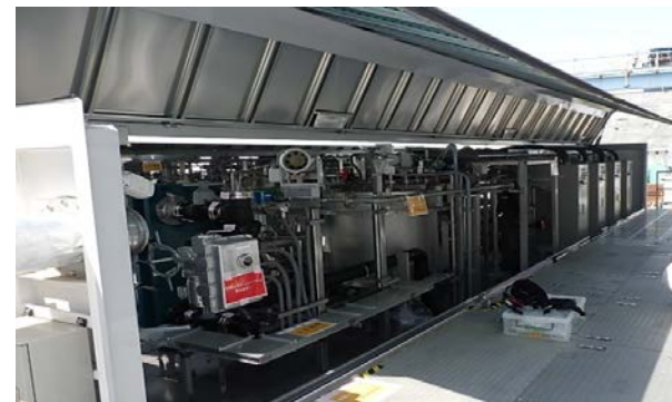
油処理装置設置状況 (第1油分解コンテナ)
