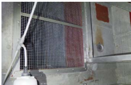
ダクト開口部 閉止前
