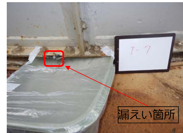
I7タンク漏えい箇所
