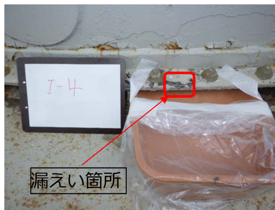
I4タンク漏えい箇所
