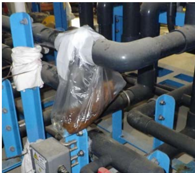
③ROモジュール出口配管フランジ部
