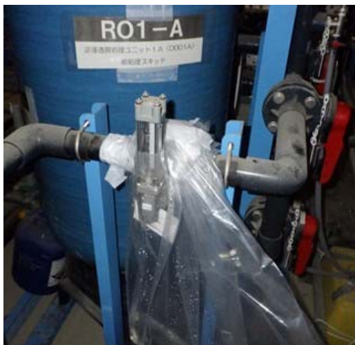
①急速ろ過装置（A）入口流量計
