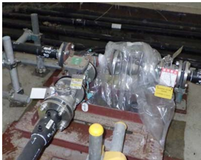
④ROドレン出口逆止弁フランジ部
