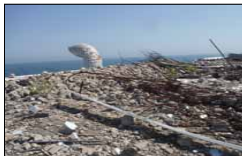
【ガレキ撤去前】 (ガレキの多い箇所)
