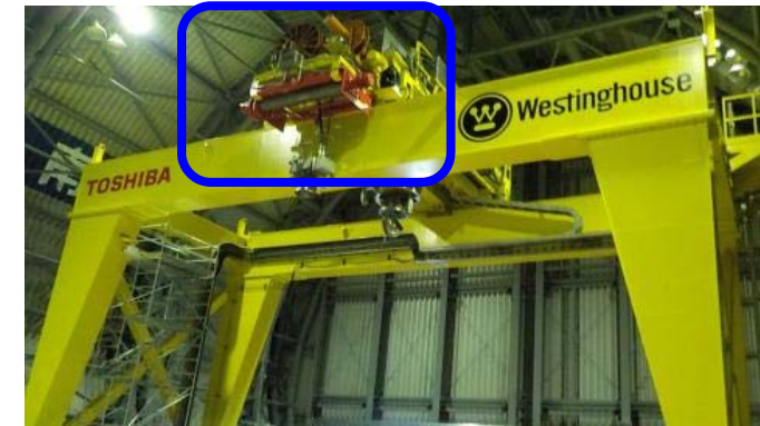
クレーン（○部：補巻）
