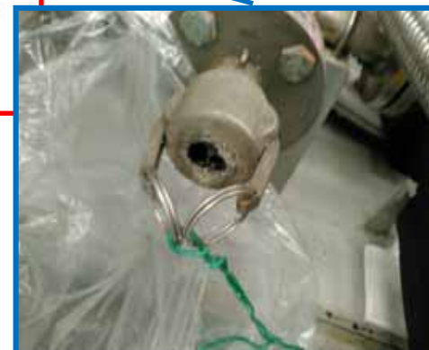
< 吸着塔11A閉止プラグ >
