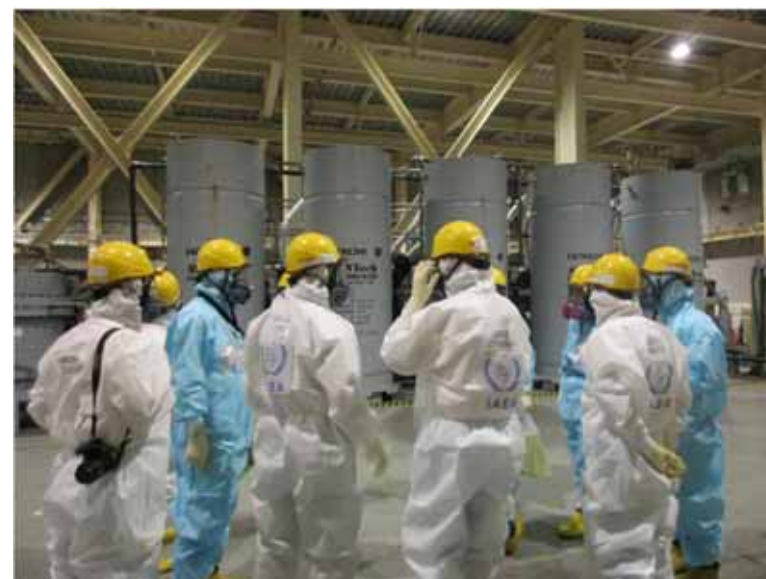
サブドレン浄化設備
