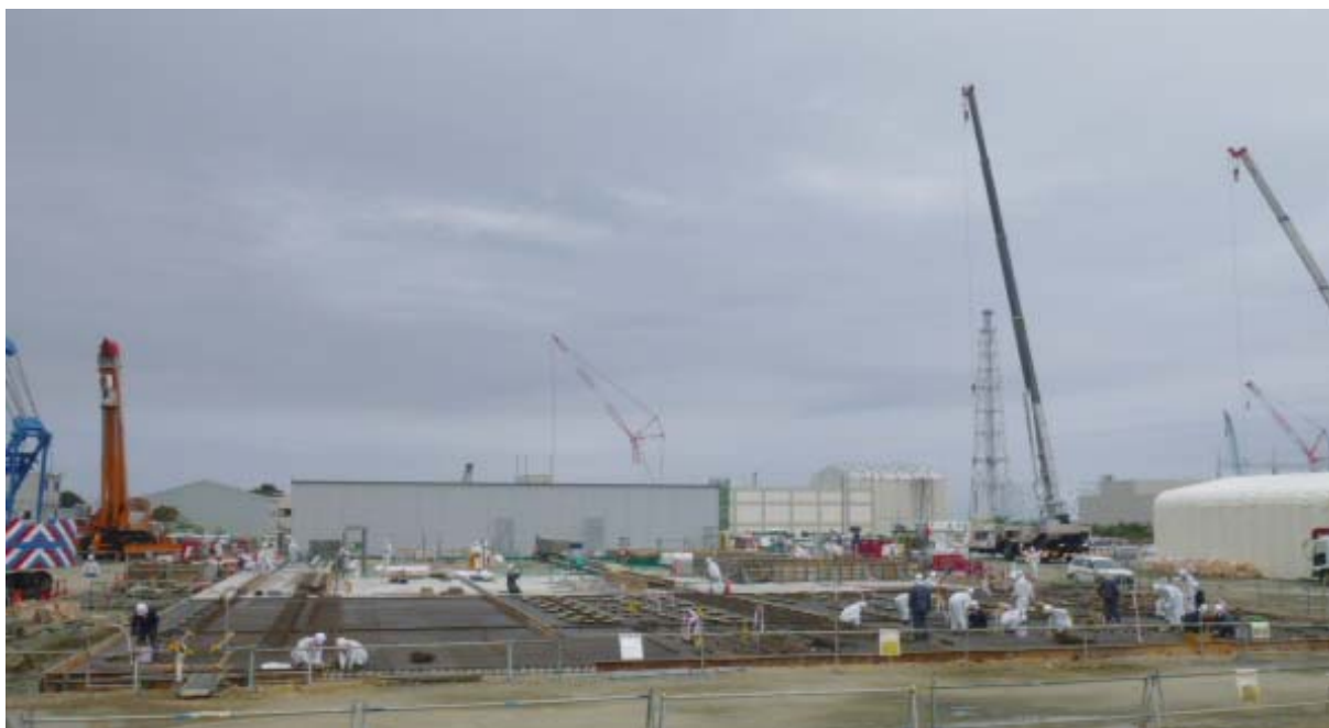
装置設置エリア全景
