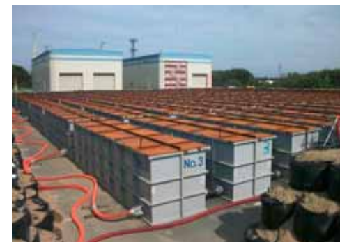
鋼製角形タンク
