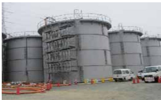
鋼製円筒型タンク（フランジ）
