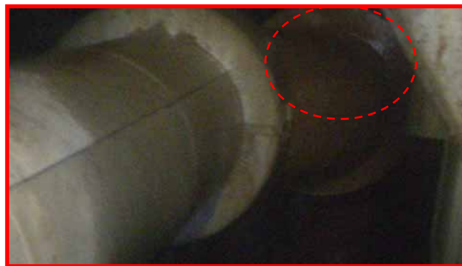
OP.5,900付近: 上部より水が落ちていることを確認
