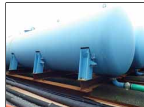
鋼製横置きタンク
