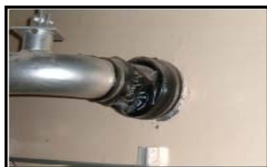
配管スリーブ貫通部
