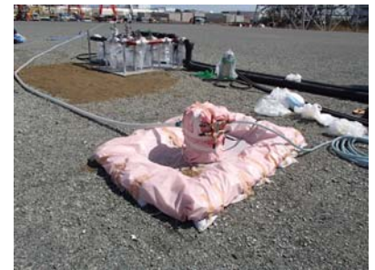
No. iii 貯水槽のポンプ設置状況(4/13撮影)
