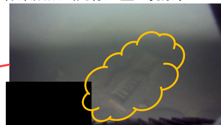
干渉物の例（落下したダクト） ※移動済
