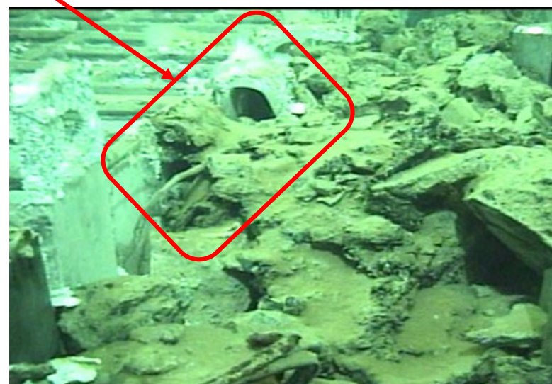
吊りピース変形
