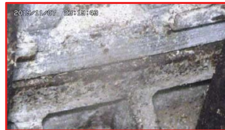
PCVフランジ部
