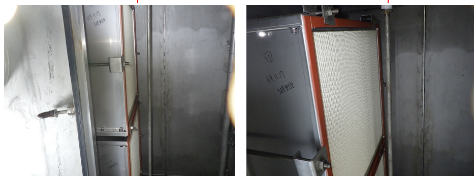
HEPAフィルタ (No.1)
