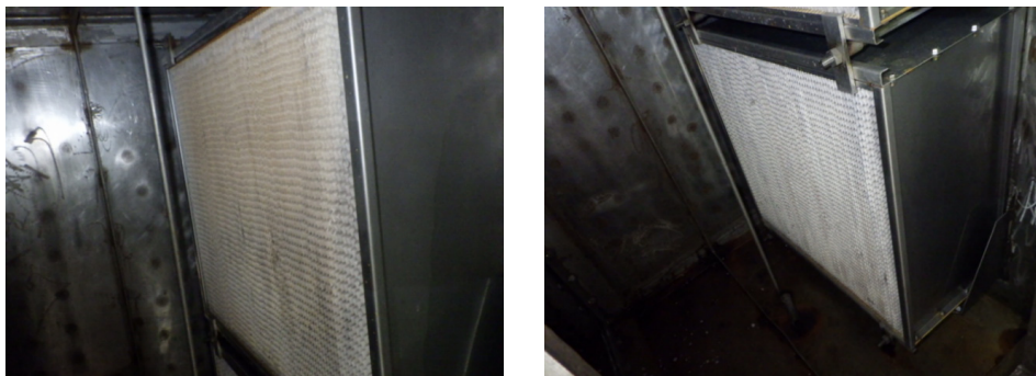
HEPAフィルタ (No.3)
