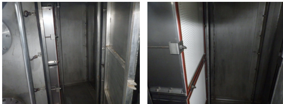
HEPAフィルタ (No.3)
