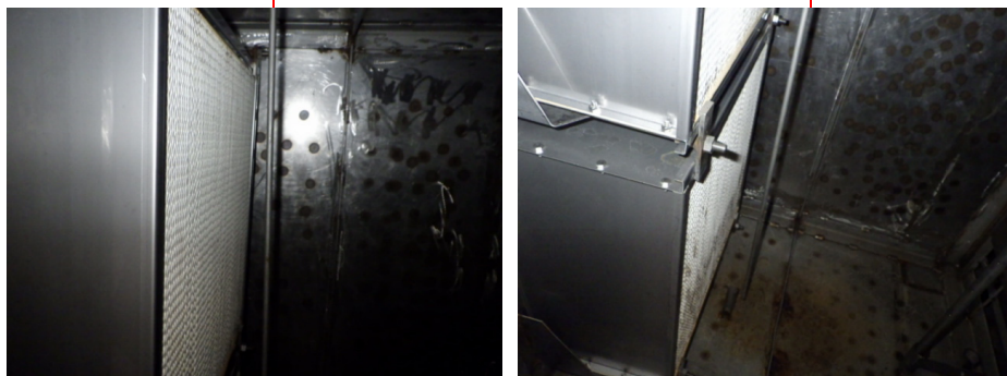
HEPAフィルタ (No.1)
