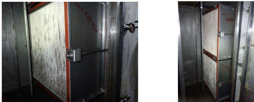
HEPAフィルタ (No.3)
