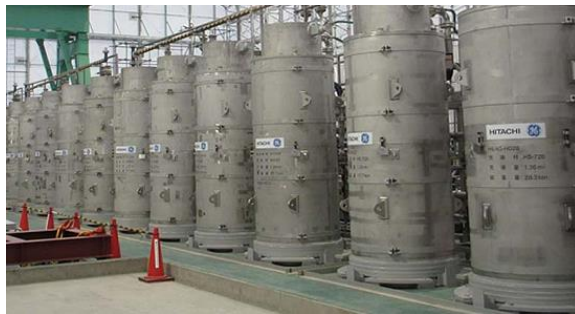
図3 高性能多核種除去設備
