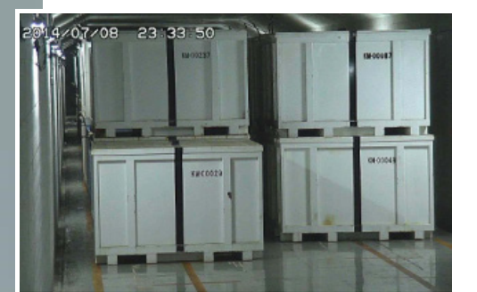
固体廃棄物貯蔵庫
