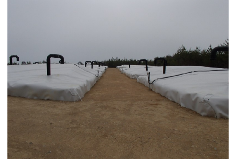
伐採木一時保管槽
