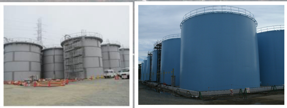
タンクの設置状況
