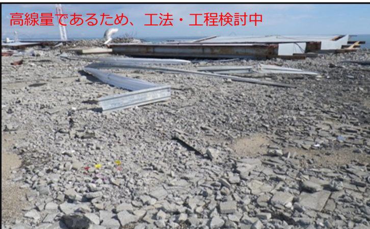
【現況】3号機T/B屋根 : 約20mSv/h
