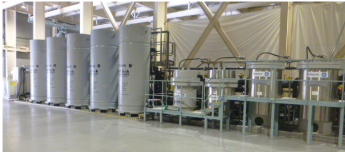
サブドレン他浄化設備 (B系)
