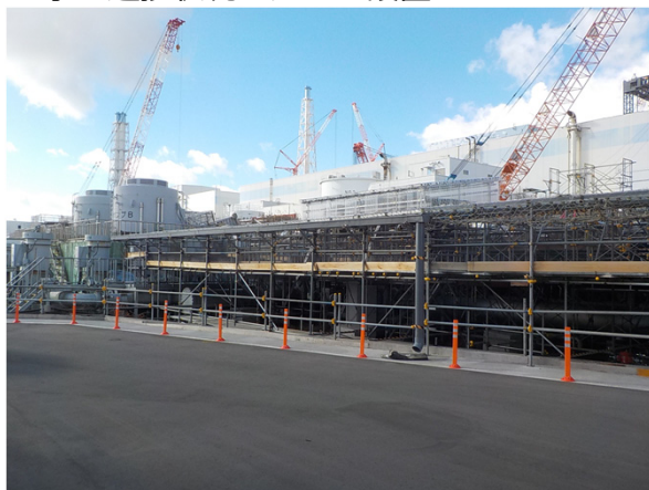
サブドレン移送ポンプ建屋周辺
