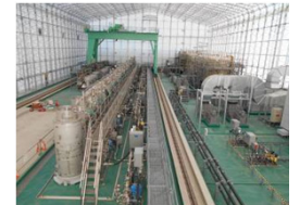
(高性能多核種除去設備)
