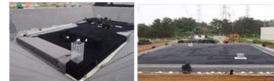
＜地下貯水タンク設置状況＞
