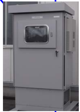
水位データ 集約伝送盤
