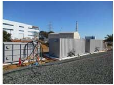
モバイルRO装置コンテナ外観
