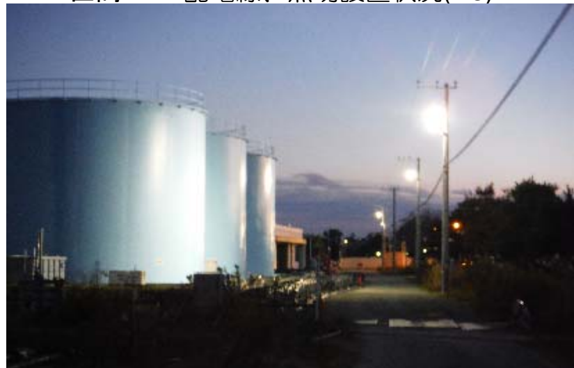
区間-E エリア照明点灯状況(H8)
