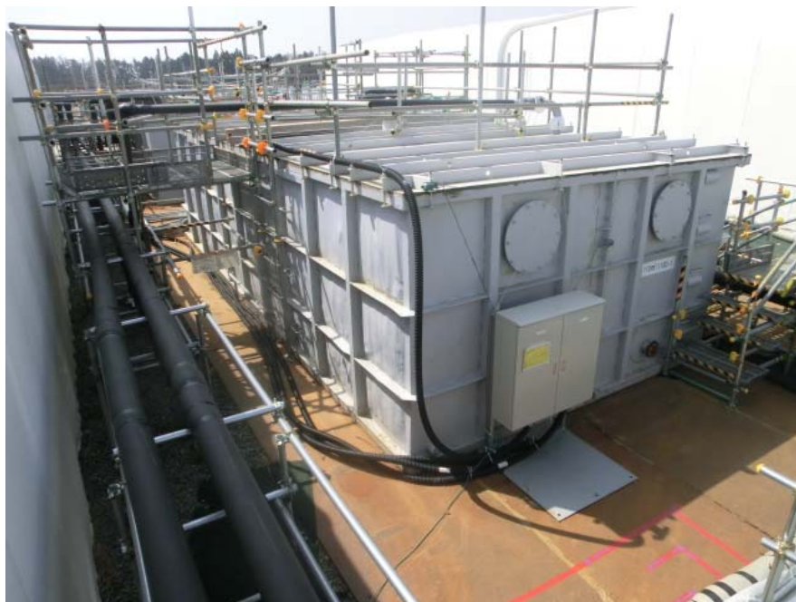
RO濃縮水一時受タンク周辺 (奥のタンクはRO処理水一時受タンク)
