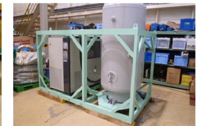
エアドライヤー・ レシーバタンク
