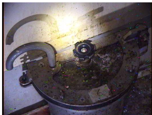
2. 機器ファンネル
